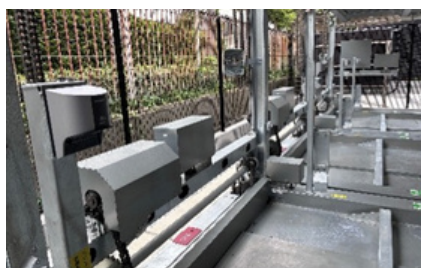
集合住宅・オフィスビルに多い機械式駐車場へのEV充電器設置例
