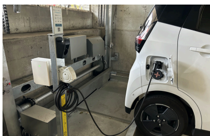
機械式駐車場でのEV充電中の様子。駐車後にアプリで充電開始・料金支払いが完結。
