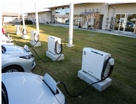
「道の駅なみえ」へは5台のV2Hを設置
