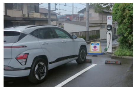
ルートインホテルズでは宿泊客以外の利用を制限するため補助金を使わずに充電器を設置
