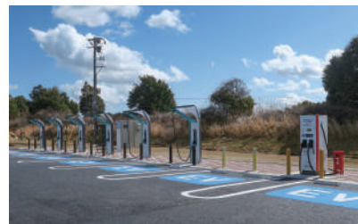
最大90kW×6口,最大150kW×2口と合計8口が整備された新東名浜松SA(下り線)
