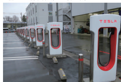
日本国内最大となる12基が設置された特斯拉「スーパーチャージャー東京・芦花公園」の事例
