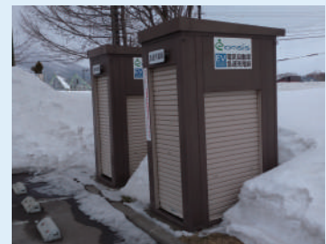
豪雪地の道の駅のEV充電設備例
