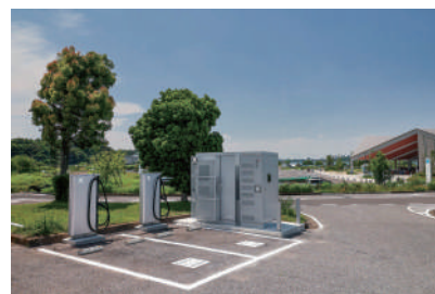
358kWhの大容量蓄電池を備えた急速充電器を設置した道の駅しようなん(千葉県柏市)
