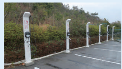
6kW普通充電器の例
