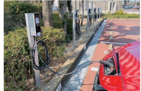
集合住宅の来客用駐車場に6kW普通充電器6台を設置した事例(画像提供/ユアスタンド株式会社)
