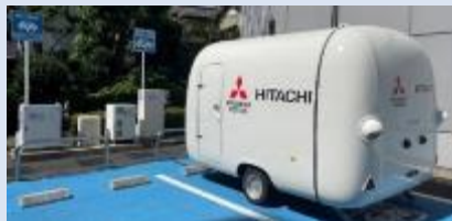
可搬式リユース蓄電システム
